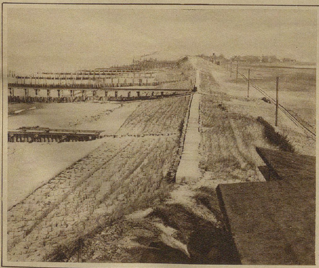
Bau von Buhnen. Heranziehen einer neuen Vordüne über dem Damm mit Hilfe von Sandgrasplantzungen bei Damkerort
