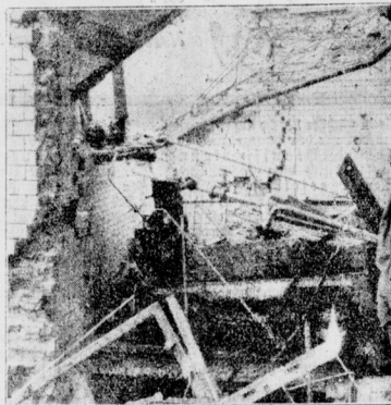
Die zusammengestürzte Garage
