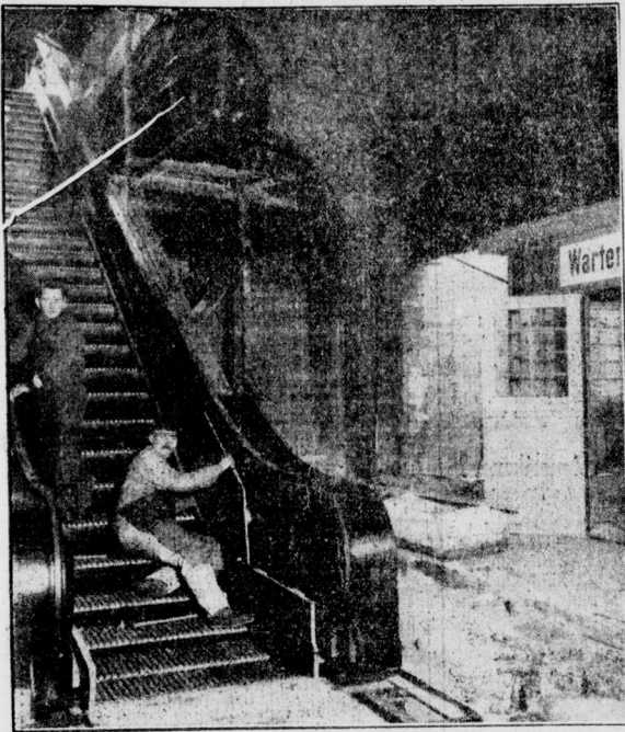
Die Stadtbahn baut eine Rolltreppe Auf dem neuen Kreuzungsbahnhof „Ausstellung“ wird den oberen und unteren Bahnsteig eine Rolltreppe verbunden. D. P. P. Z.
