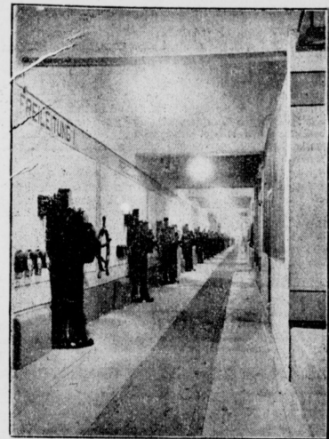
Der Oelschalterbedienungsang im Umspannwerk
