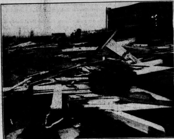
Das Dach einer Halle im Transformatoren-Werk Lichtenberg wurde abgehoben und stürzte auf eine danebenliegende Werkstatt
