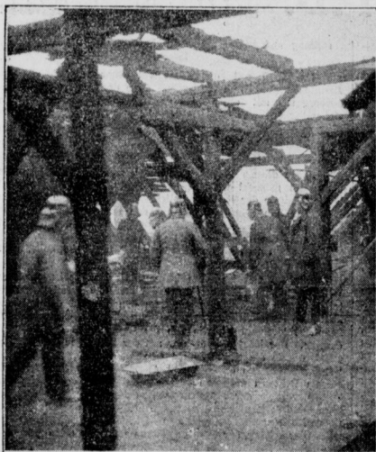
In der Dresdener Strasse brach heute früh in der im zweiten Hof gelegenen Fabrik ein Dachstuhlbrand aus
