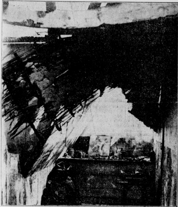
In einer Bodenkammer brach ein Brand aus, der sich in kurzer Zeit über den ganzen Dachstuhl verbreitete
